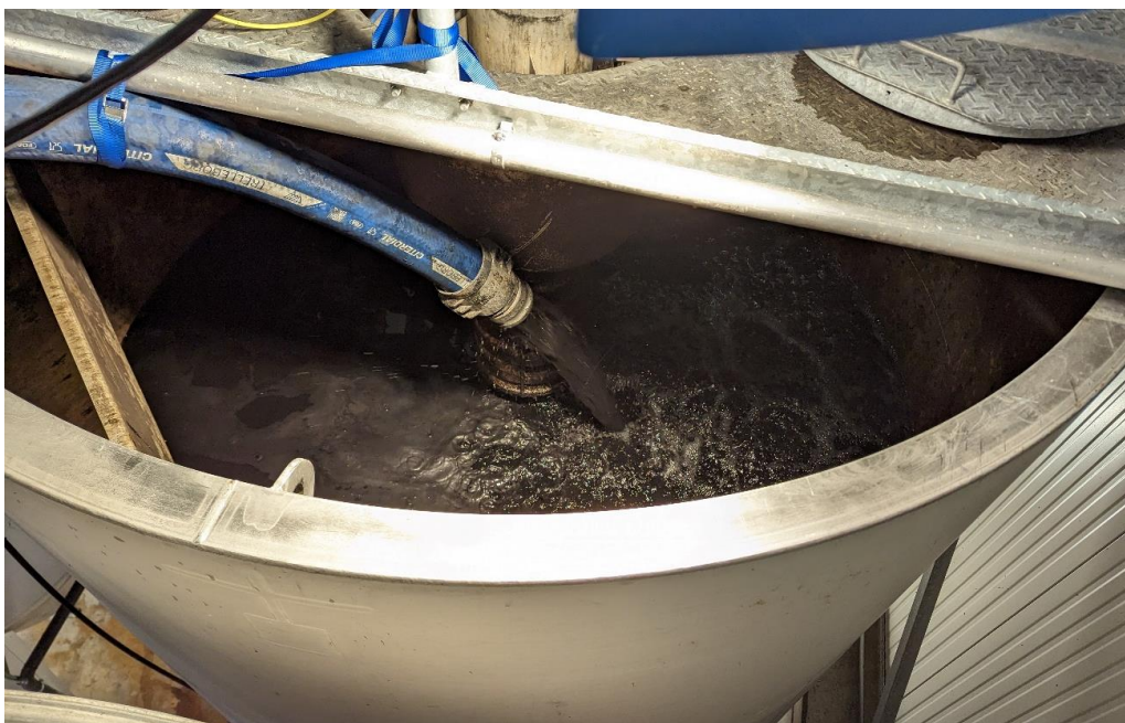
Abbildung 1: Befüllung der Filter mit frischer GAK (März 2023)
